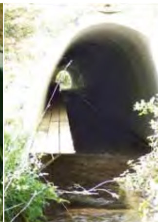
Absence de rampe d'accès
