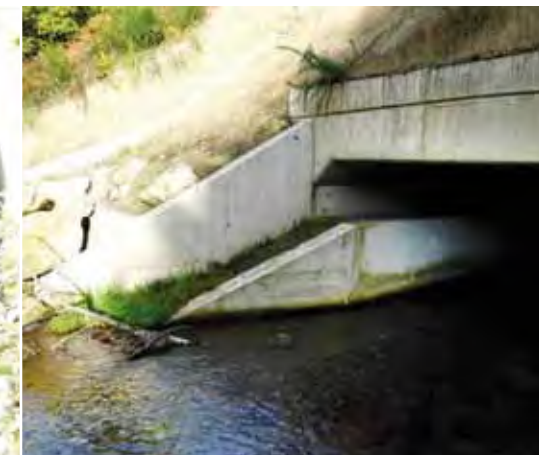
Rampe d'accès non raccordée à la berge
