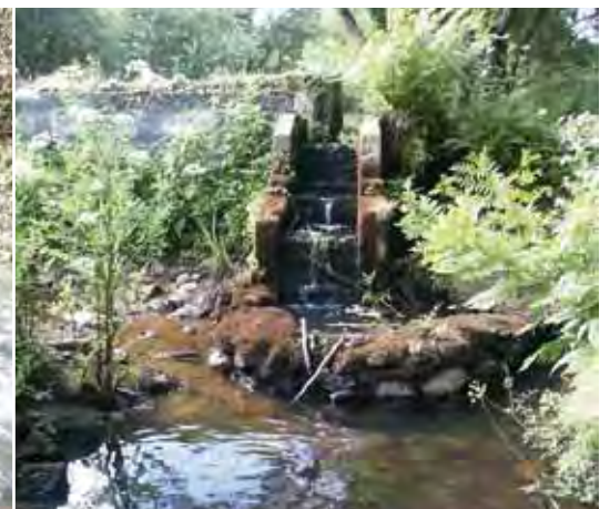
Conception déféctueuse de dispositif de franchissement
